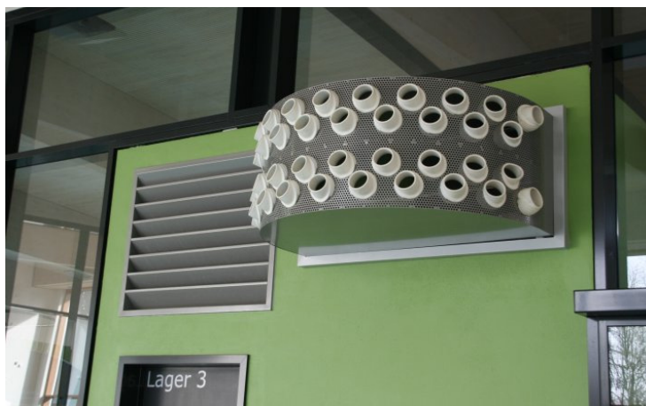
Abbildung 24: Weitwurfdüsen für die Zuluft in Halle 3. Die unteren und oberen beiden Reihen der Düsen können getrennt angefahren werden. Links im Bild befindet sich die Abluftöffnung (mit Lamellen).
