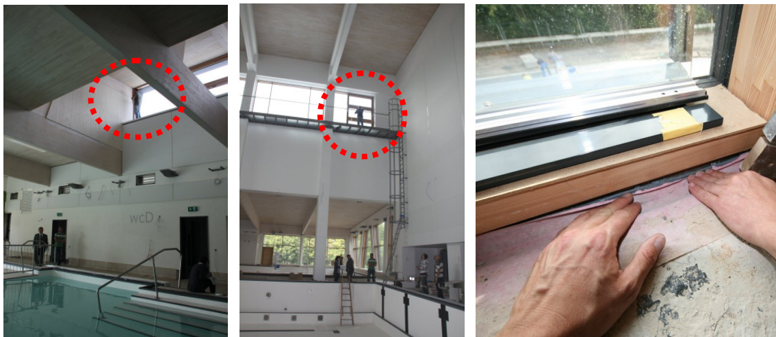
Abbildung 13: Beispiele für die Leckagesuche bei 50 Pa Unterdruck im Bereich der Dachgaube (Halle 1+2) (links) und an den Fenstern im oberen Bereich von Halle 5 (mitte) sowie die abgelöste Verklebung an der Abdichtung der Pfosten-Riegel-Fassade zur Brüstung (rechts)
