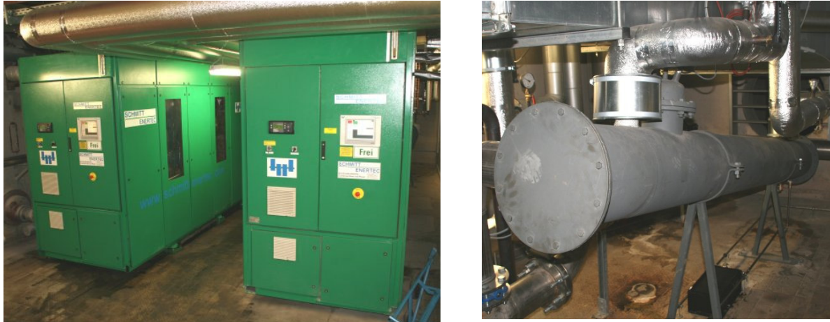
Abbildung 17: Heizungsraum im Keller (Altbaubereich) mit den beiden BHKW-Anlagen (links) und einem der beiden Abgaswärmetauscher (rechts)
