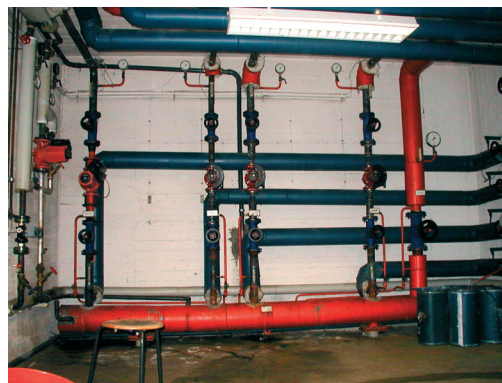
2 3 Heizungszentrale vor und nach der Modernisierung
